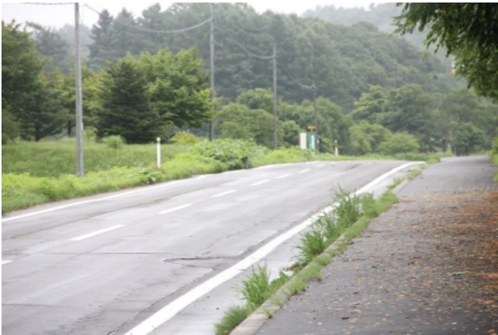
作業前、車道と歩道の境には雑草が
