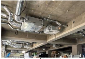
▲1階空調ダクト
